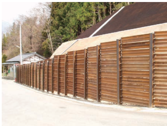
設置したH形鋼支柱に専用固定金具で鋼矢板を取り付ける
