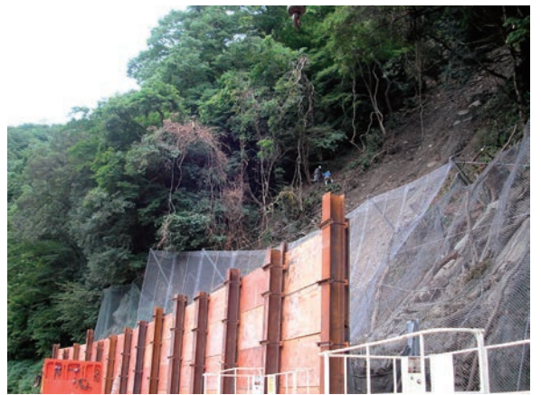
法面災害発生直後の状況
