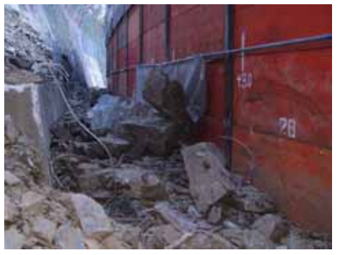
工事中に発生した落石
